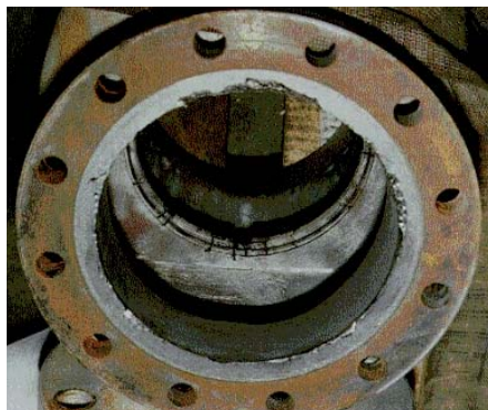
Bild 2: Zerstörung durch Bypass-Leckage Fig. 2: Destruction by bypass leakage
